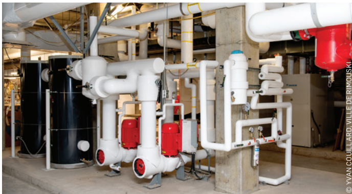
Pompes et refroidisseurs
