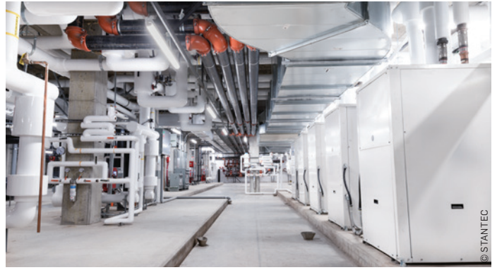
Salle mécanique de la piscine, incluant les thermopompes
