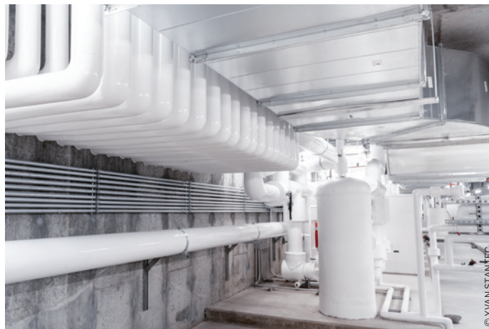
La nourrice de géothermie
